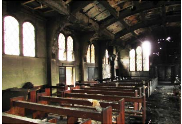
Se aprecia el daño causado por el fuego, al interior de la parroquia San Sebastián.
